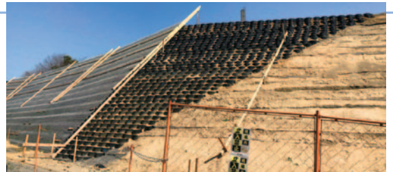
▲御殿山小倉線 法面復旧工事現場(3月中旬撮影) 2023(令和5)年度末の完成を目指している
